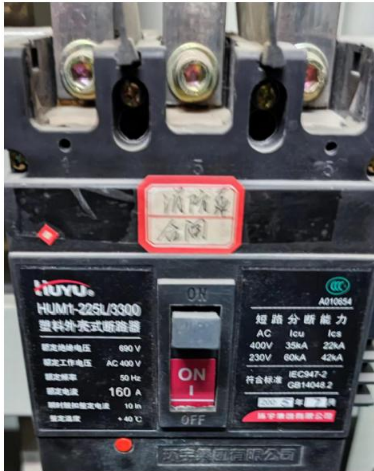
图 3.12 消防控制柜电闸
