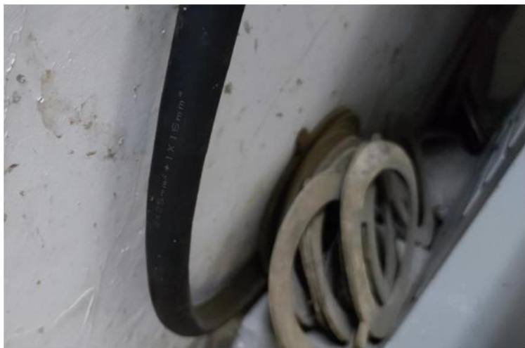
图 3.11 泵房进线电缆
