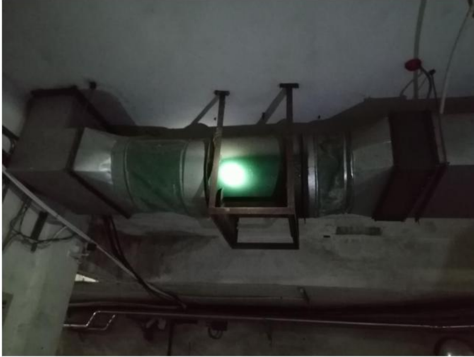
图 3.14 地下排烟风管
